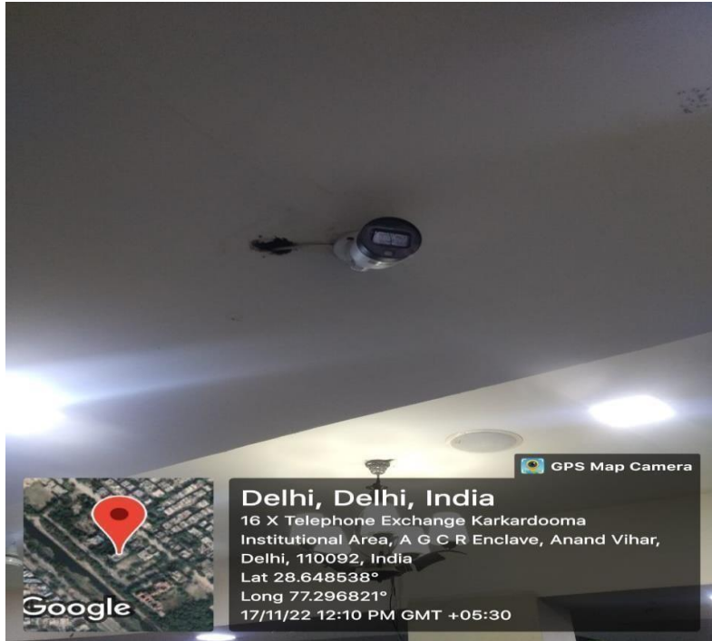
Main Auditorium ,CCTV - 02
